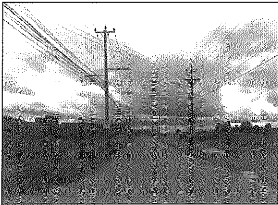
Figura 5: Luminaria existente en el arco Sur de la Intersección Anortosita- Granítica.
